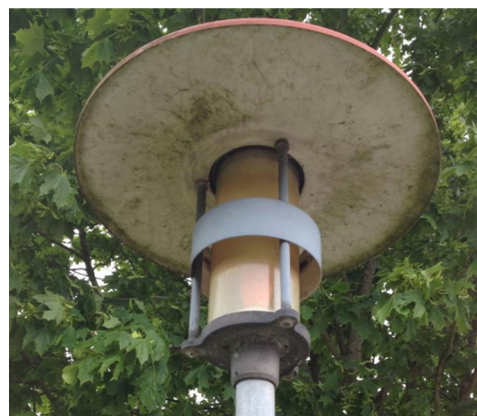
Eksisterende park lampe før udskiftningen
