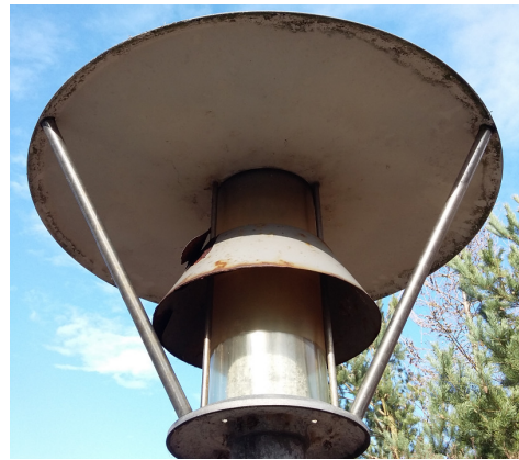
Eksisterende (Inden renovering) 80W / 120W lampe
